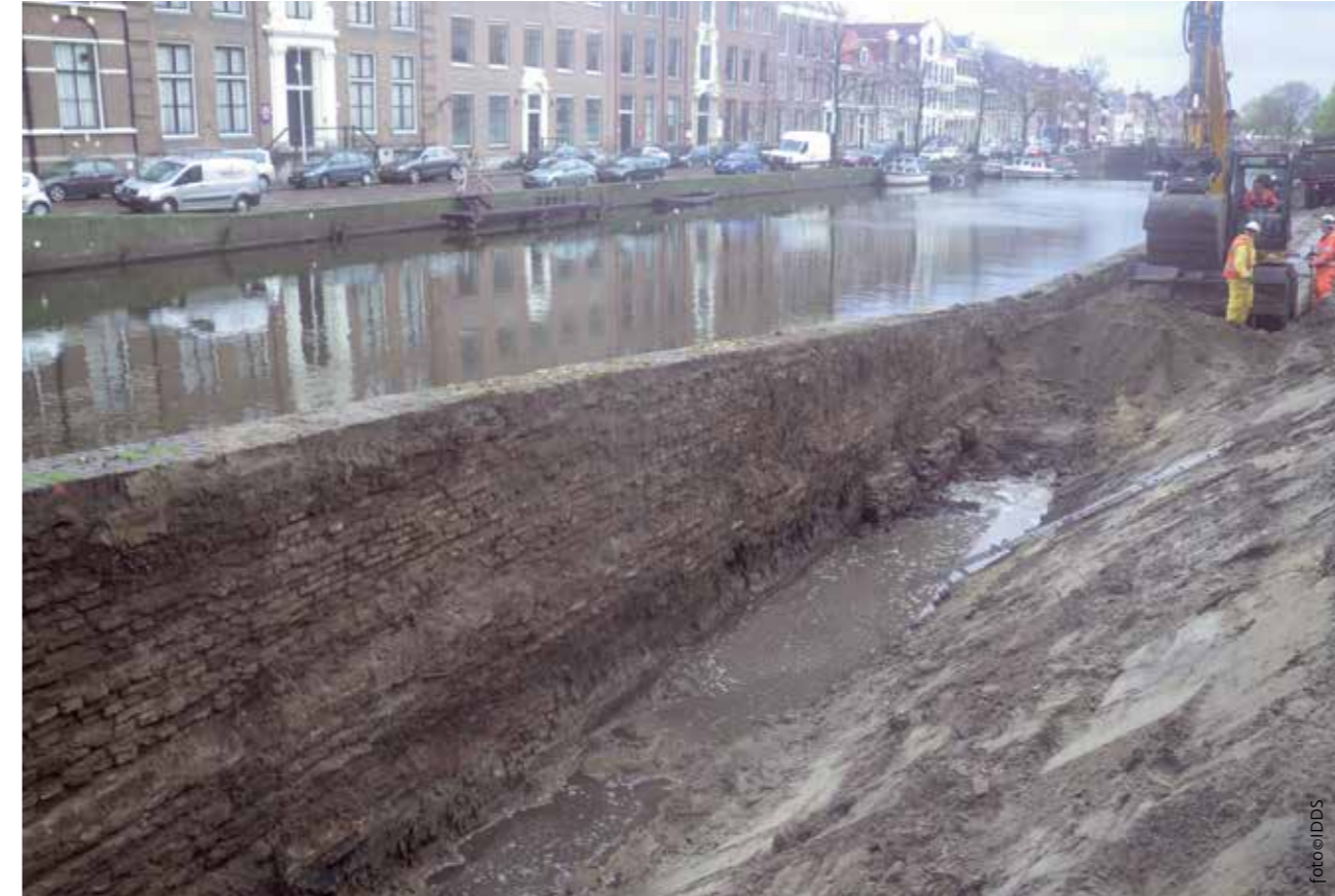
De kademuur ter hoogte van Kruisstraat 1 met daarop zichtbaar de verstevigingen bij de fundering.
